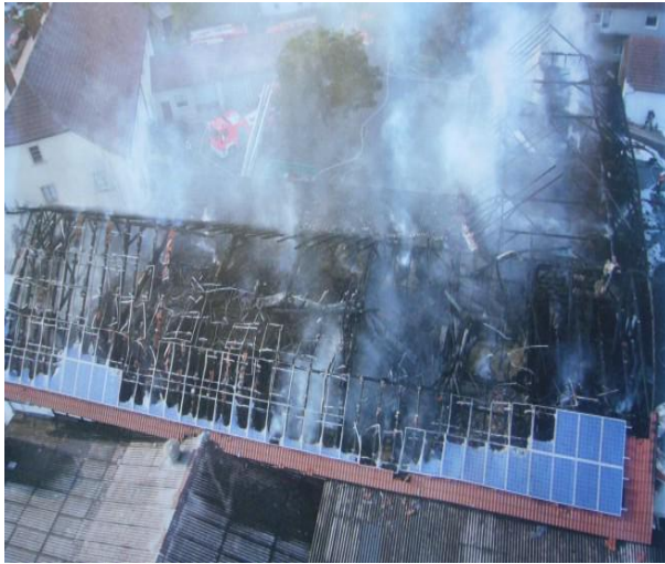
图 3-1 光伏屋顶的太阳能组件“自燃”
