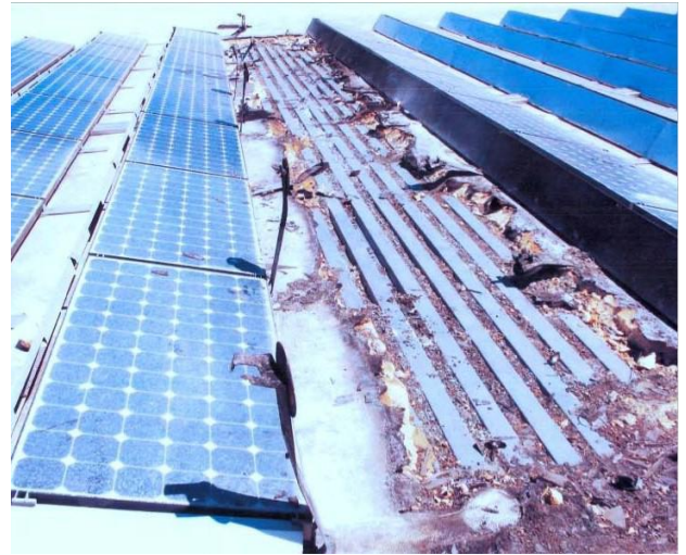
图 3-2 屋顶太阳能光伏电站“自燃”现场
